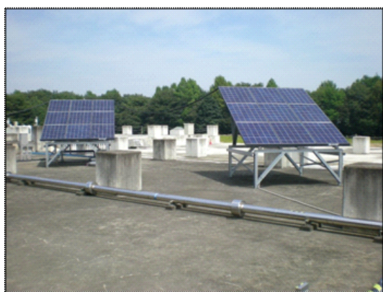
図2 太陽光発電システム設置状況 (向かって左側が冷却装置付)
