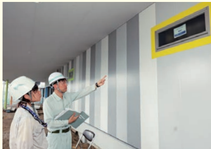
【工事監理】とちのきファミリーランド事務所 整備工事 (栃木県民公園福祉協会)
